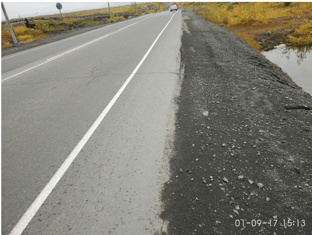
Рис. 2. Система продольных и поперечных морозобойных трещин. Автодорога «Норильск – Талнах», район турбазы «Наледная»
