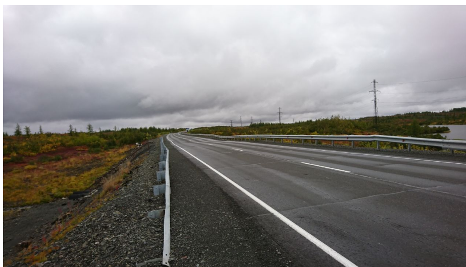
Рис. 4. Сползание откоса и крен дорожного полотна, трасса «Норильск – Дудинка», 15 км восточнее г. Дудинки, 4.09.2017
