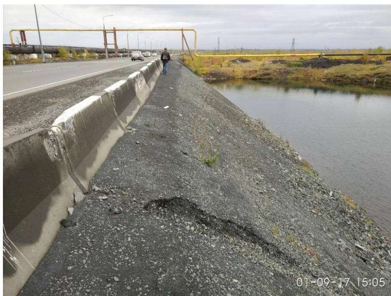
Рис. 6. Размыв и сползание откоса на трассе «Норильск–Талнах» при активизации термокарста (участок вблизи промплощадки НЭР, ремонт через каждые 2 – 3 года)
