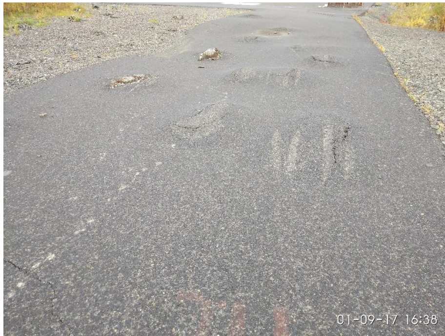
Рис. 3. Выпучивание остатков свайных опор на автодороге в аэропорт «Валёк»
