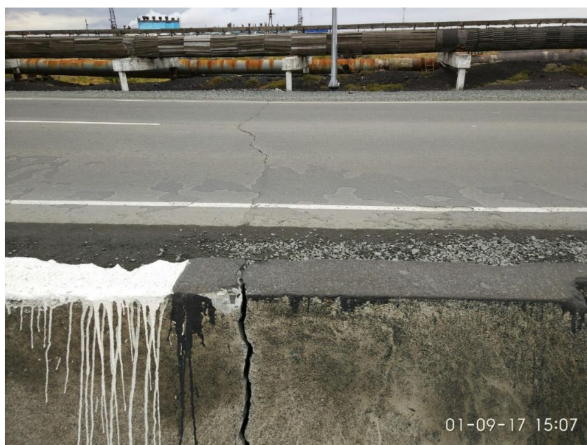
Рис. 1. Морозобойная трещина покрытия автодороги «Норильск – Талнах» в районе пос. Купец
