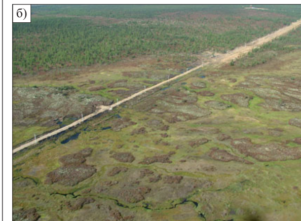
Рис. 14. Быстрое протаивание многолетнемерзлых грунтов и миграционных бугров пучения в долине ручья Озерный в 10 км южнее стационара Керак (Южная Якутия) вдоль трассы нефтепровода ВСТО-1: а — август 2010 г. (фото Ю.В. Станиловской), б — август 2011 г. (фото М. Разумец)
