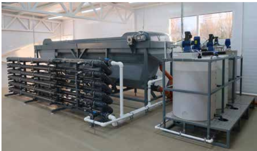
Фото установки очистки сточных вод на предприятии
