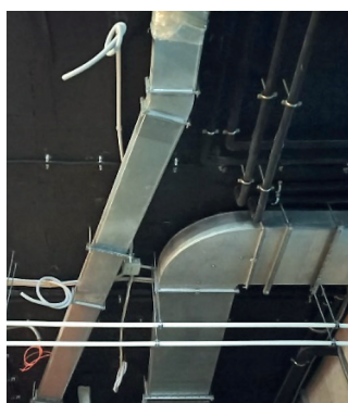
Воздуховоды и изолированные трубы технологии «холодный потолок» АНО «НИИУРС»
