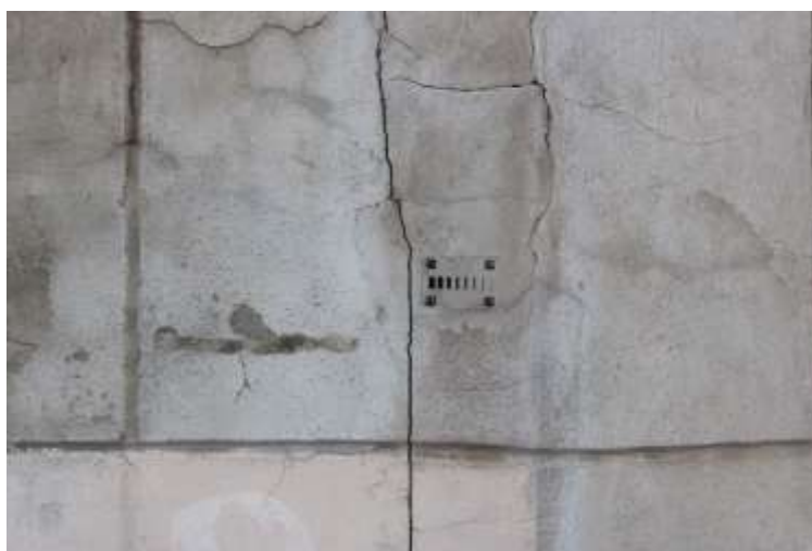
Рис. 7. Тестовый снимок участка трещины с закрепленной шкалой
