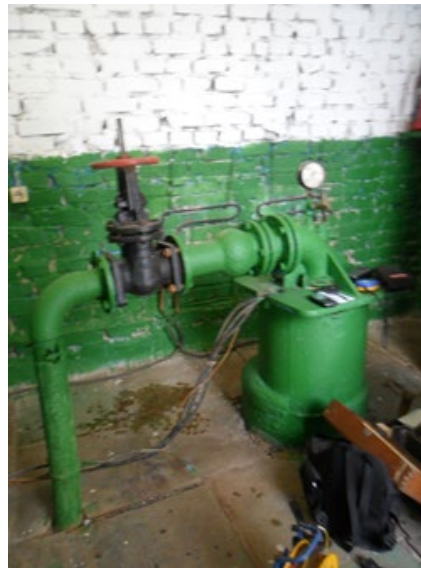
Рис. 2. Водозаборная скважина централизованного водоснабжения на подольско-мячковском водоносном горизонте.
