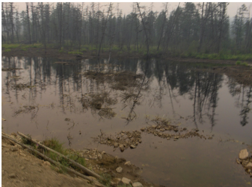
Рис. 1.2.1. Возникновение подтопления и активизация термокарста на участке строящейся железной дороги «Улак — Эльга», юг Якутии. Фото В. Исакова
