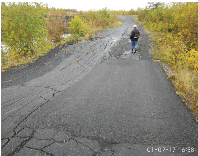
Рис. 1.2.8. Деформации дороги к рекреационному комплексу «Валёк» при вытаивании подземных льдов в основании и развитии термокарста на примыкающих участках, Красноярский край, Норильский промрайон. Фото В. Толманова
