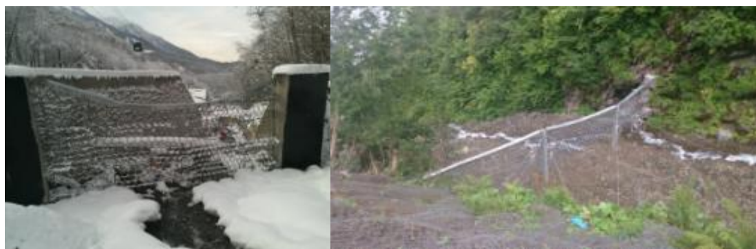
Рис. 2. Примеры устройства гибких селеудерживающих барьеров, используемых для инженерной защиты горнолыжных объектов в Сочи
