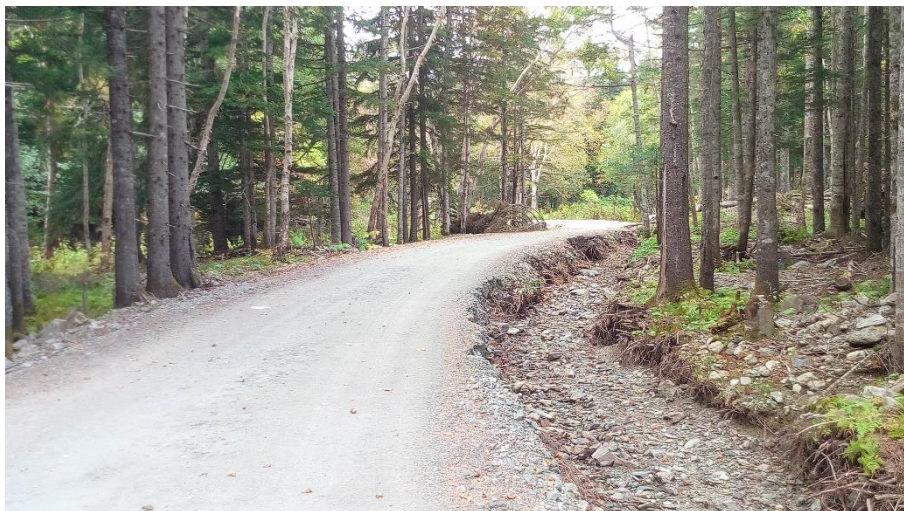
Рис. 9. Эрозионный врез по кромке дороги, образованный при переливе воды через дорожное полотно при паводках, 2019 г. Фото Л.Е. Музыченко
