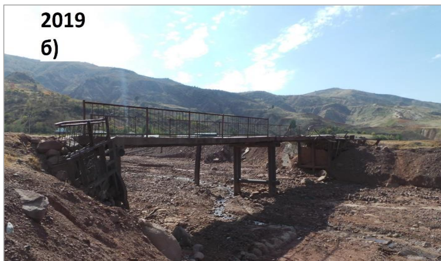
Рис. 7. Разрушенные селем мосты и берегоукрепительные сооружения. Фото М.М. Азимшоева
