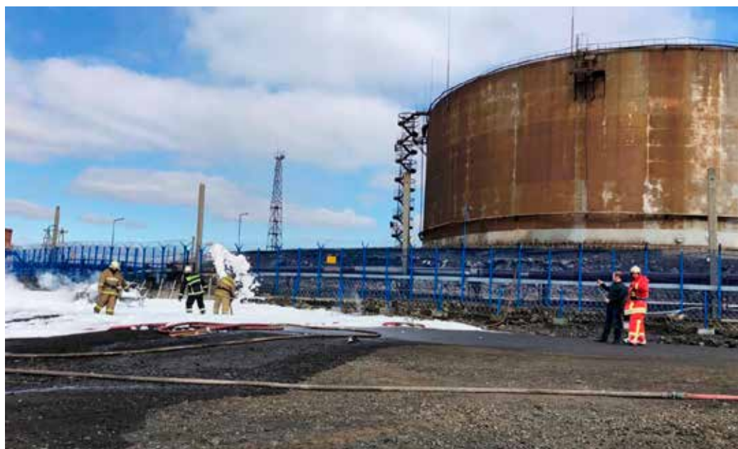
Рис. 2. Аварийный топливный резервуар компании «Норильский никель».
