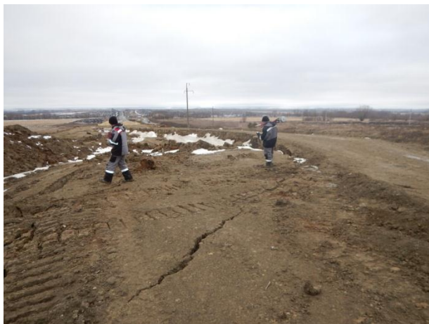
Рис. 6. Начало отделения и оседания западной половины дорожного полотна, появление стенки срыва в южной части оползня.
