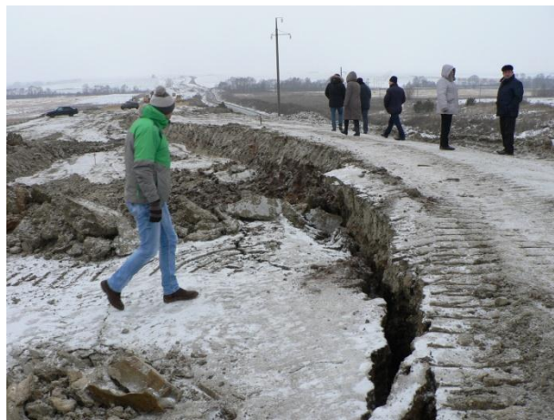
Рис. 7. Полное отделение оползня с частью дороги и смещение в западном направлении.
