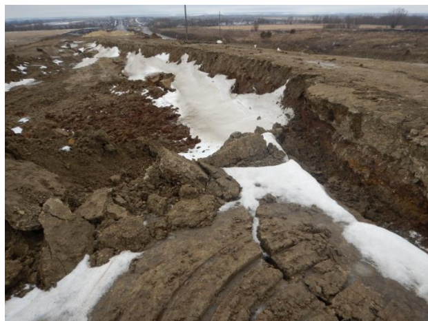
Рис. 5. Южная часть головного блока с признаками вращения и оседания. Стенка срыва разорвала проезжую часть дороги.
