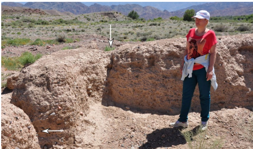
Рис. 5.16.9. Трещины на всю высоту сохранившихся стен обоих простираний в Северном городище Сыры-Булун. Вид на ЮЮВ. ◀
