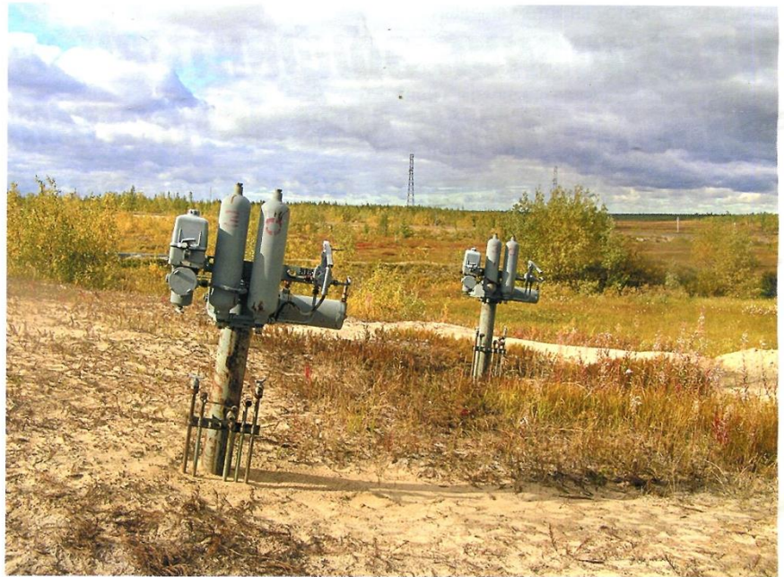
Рис. 6. Наклон кранов байпасной линии кранового узла вследствие пучения грунта
