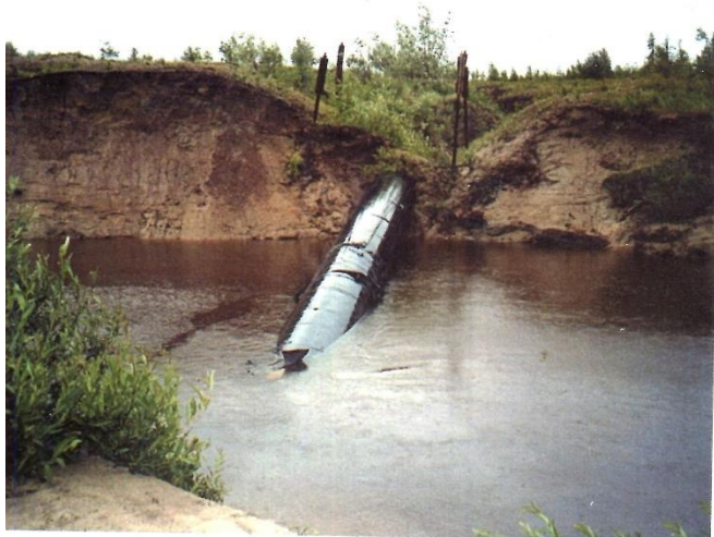
рис. 4. Участок газопровода, размытый боковой эрозией, на р. Правая Яха
