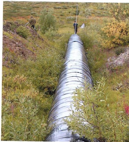
Рис. 1. Термоэрозионная форма вдоль газопровода второй нитки МПК (ПК 160)
