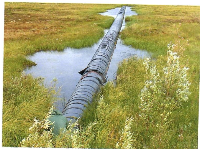
рис. 5. Термокарстовые озера вдоль газопровода
