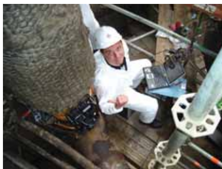
Нефтеперерабатывающая станция Raffineria di Roma, Рим (Италия)
